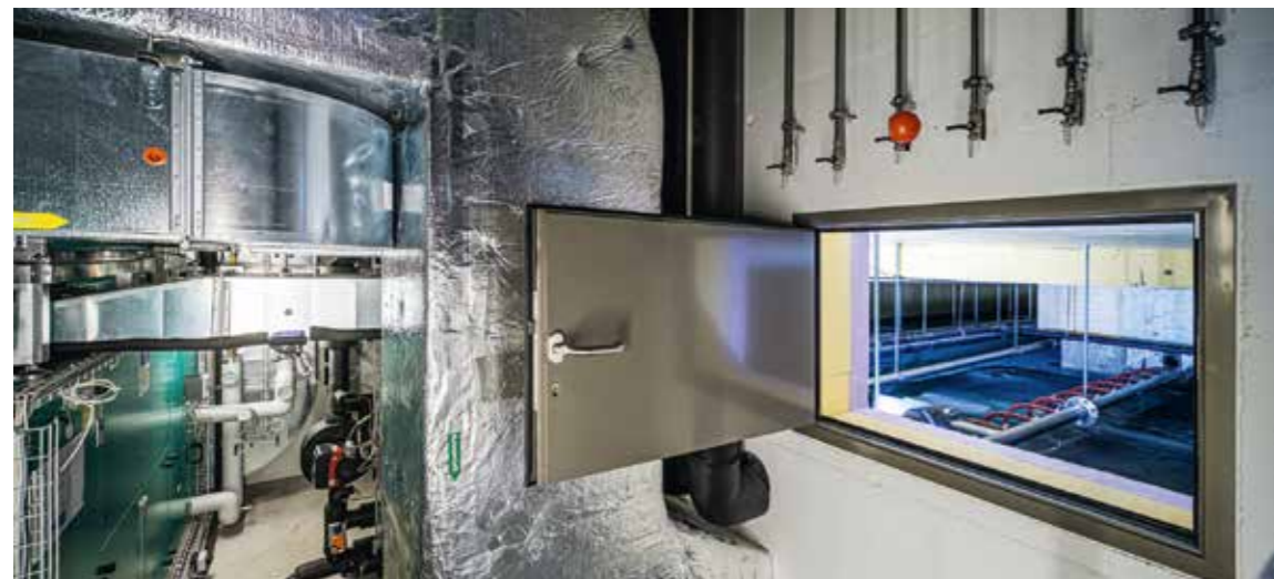
Das Viersternehotel Valsana in Arosa agiert vollumfänglich CO 2 -neutral, ist Mitglied von Swisstainable – und heizt ohne fossile Brennstoffe.
